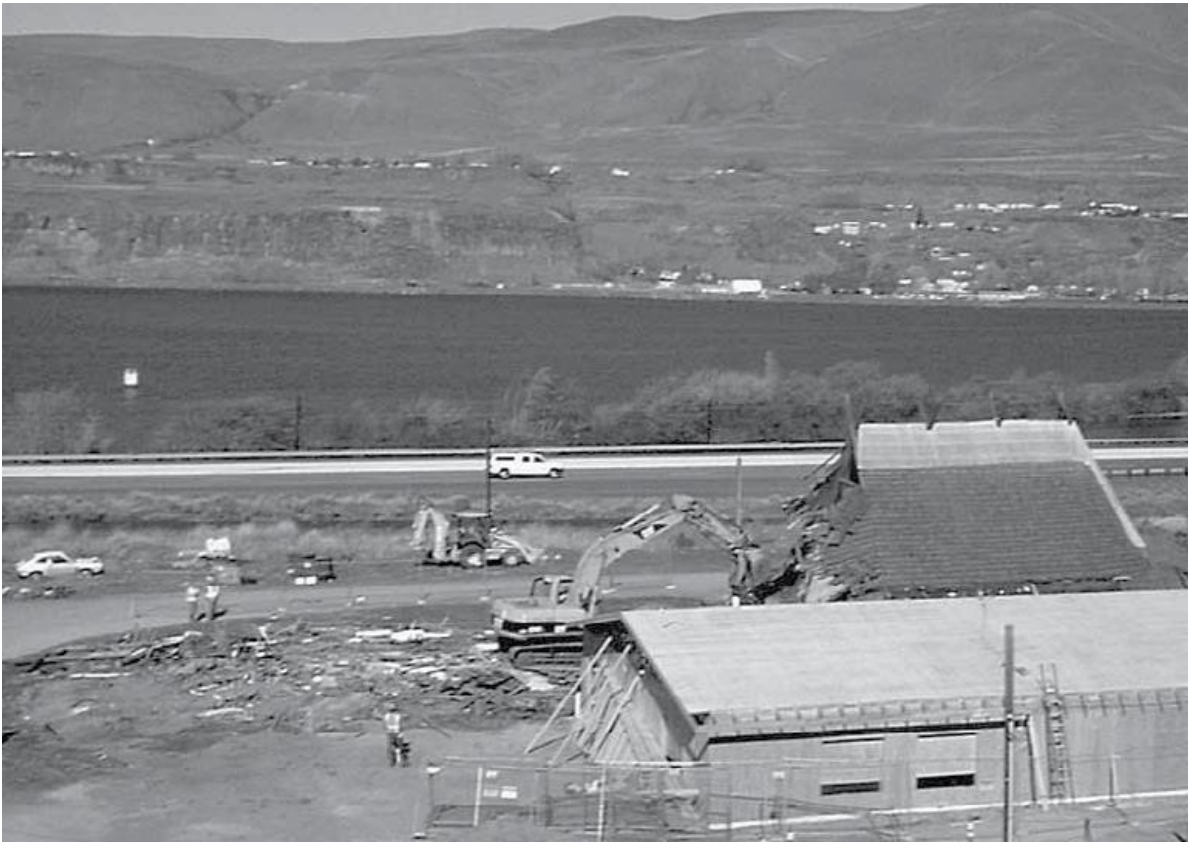
La casa comunal construida por los aldeanos a principios de la década de 1970 es derribada para preparar la construcción de la nueva casa comunal.
